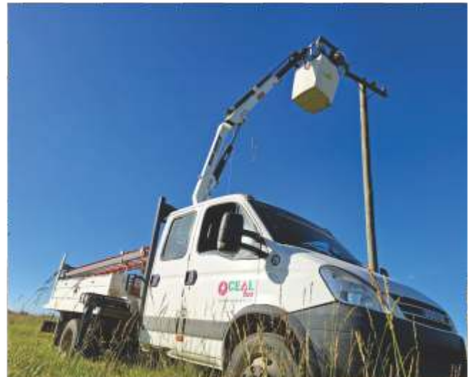
CHILLAR - Sistema rural
